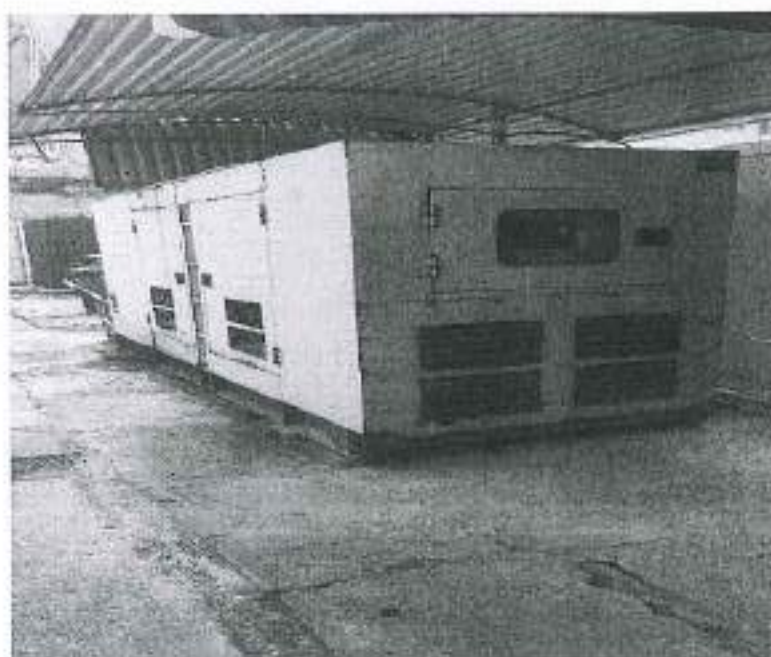
Hình 14 Máy phát điện tại cơ sở
