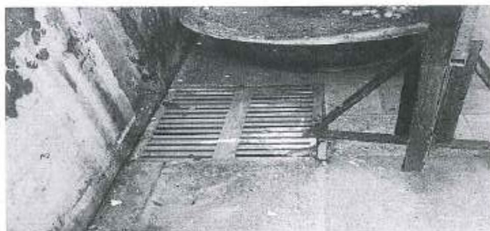
Hình 6 Hồ ga thu gom nước mưa của cơ sở
