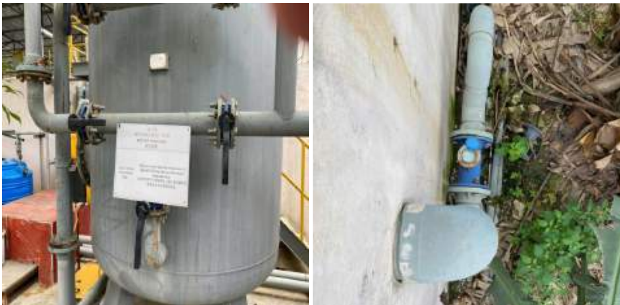
Hình 8: Hình ảnh hiện trạng công trình xử lý nước thải tập trung của cơ sở
