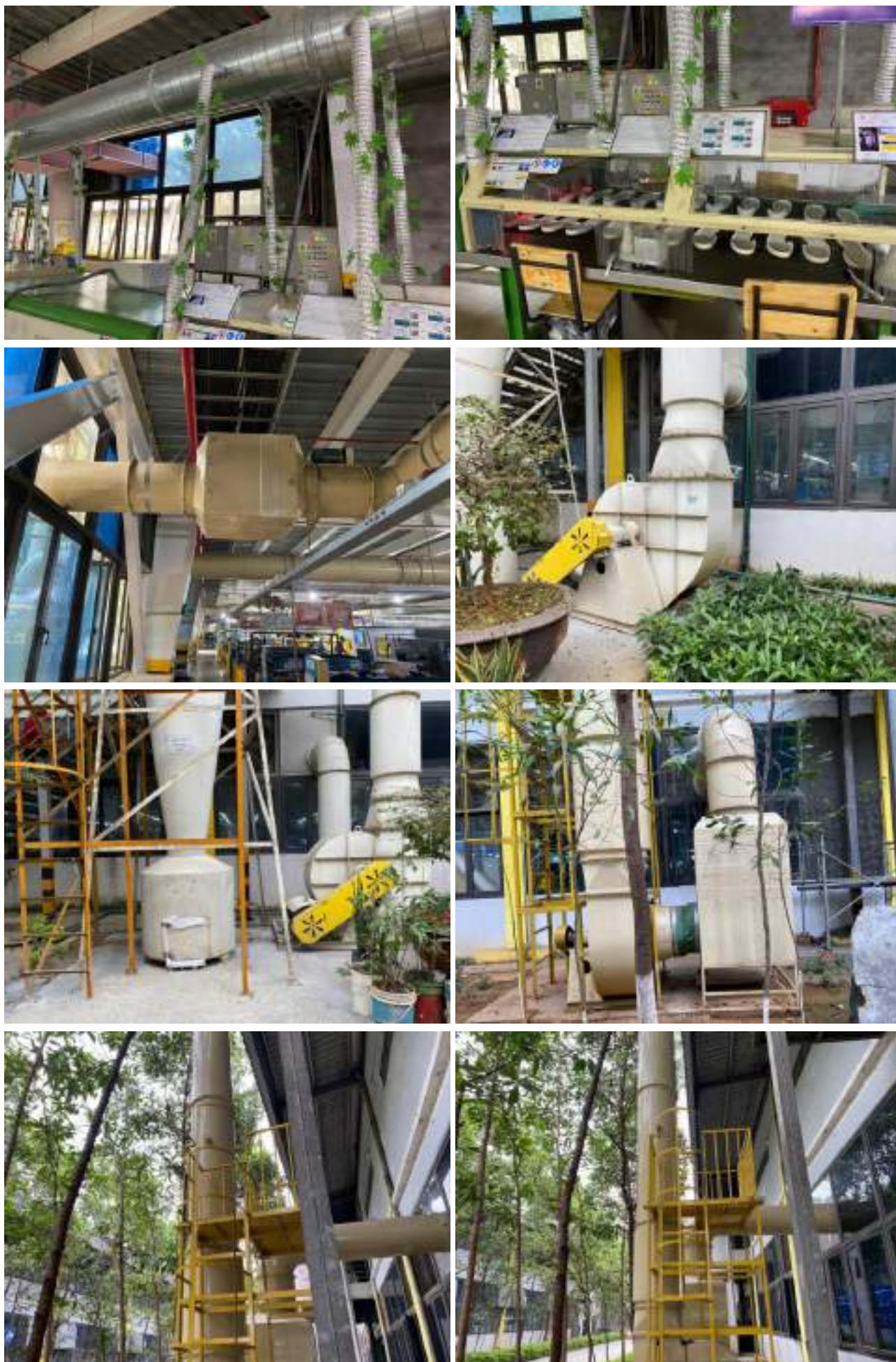
Hình 12: Hình ảnh hiện trạng công trình xử lý bụi và khí thải của dự án
